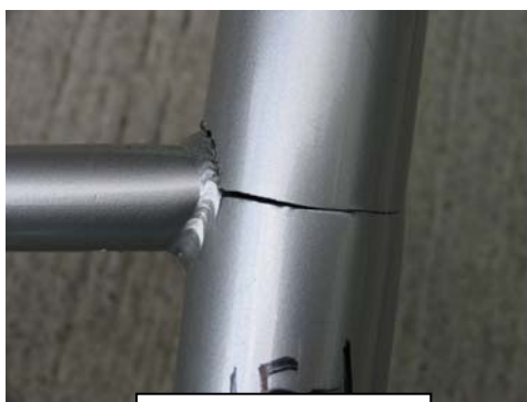
No.15 立パイプ折損
