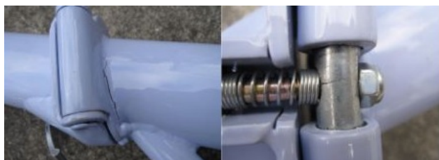
ヒンジ接合部、ロッドピン亀裂
