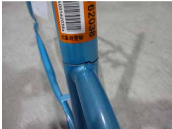
8 立パイプ亀裂
