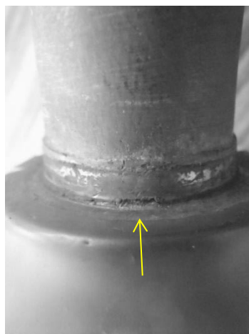
写真 11 ロード No. 7 亀裂の様子
